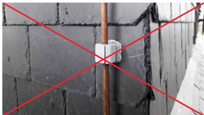
Fixation à travers les ardoises d'arêtier, à proscrire ! © SPW/AWaP
