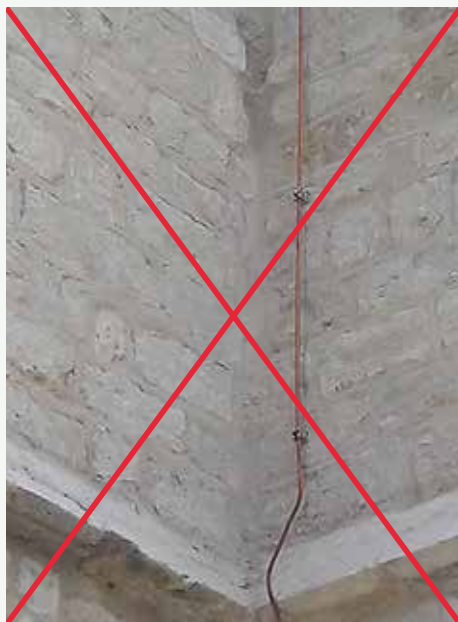
Alors que les instructions ont été préalablement données afin que les fixations du conducteur se fassent dans les joints de la maçonnerie, toutes les fixations ont été placées dans les pierres ! Il aurait suffi d'utiliser des systèmes de fixation mieux adaptés à la situation existante permettant d'aller chercher une maçonnerie plus cohérente en profondeur, en général, quelques centimètres complémentaires suffisent © SPW/AWaP
