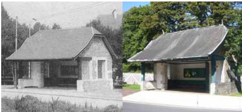
Georges Hobé, aubette de Spa-Extension (Balmoral), 1909. La comparaison montre les dégradations de la toiture et de la menuiserie. Carte postale ancienne et photo © R. Balau
