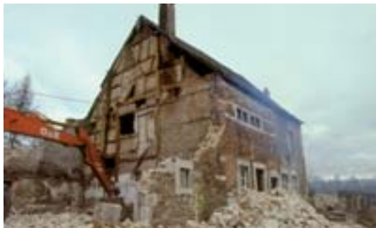
Archéologie du bâti sur le tronçon entre Soumagne et Tchimister-Clermont où plusieurs fermes typiques du Pays de Herve étaient vouées à la démolition: exemple à Cbaineux. H. Fock, Service de l'Archéologie, Direction de Liège I © MRW
