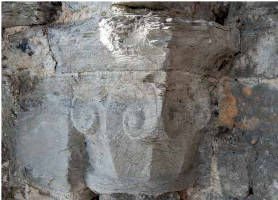
Tournai - Cathédrale Notre Dame - Parties romanes - Corbeille d'un chapiteau surmontée de son tailloir. Délamination très marquée de la pierre liée à la présence de fines lamines d'argile. Les cycles de gonflements et dégonflements durant la vie de celle-ci mèneront inexorablement à la ruine complète de l'élément. À noter que jusqu'à aujourd'hui, aucun procédé réellement pérenne ne permet d'enrayer ce processus de détérioration. G. Focant © SPW-AWaP
