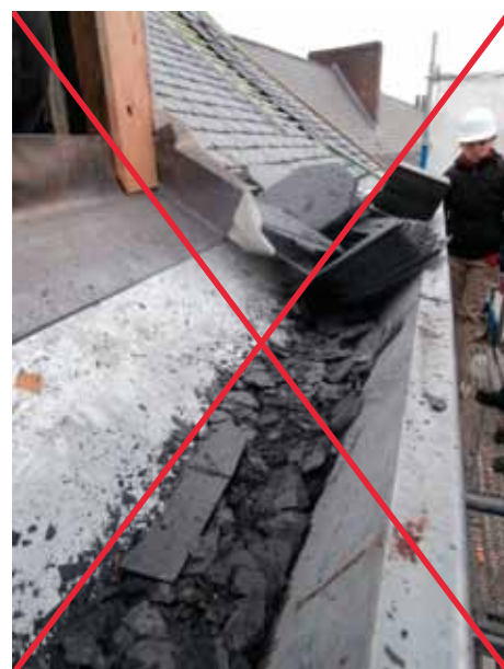
Stockage et déchets de découpe d'ardoises dans le chéneau non protégé ! © SPW
