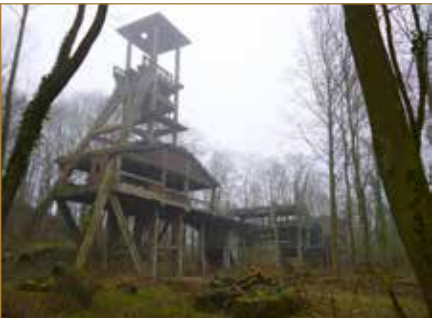
Diagnostic des bétons du charbonnage de Sauwartan (Dour) – © AWaP
