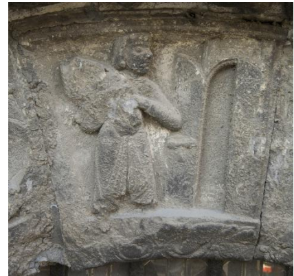
Fig. 42 Exemple d'un délitage restreint et une fine couche de gypse
