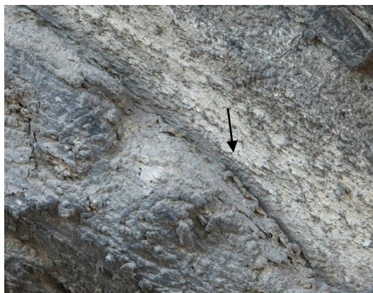
Fig. 17 Boursouflures visibles à l'œil nu sur une des sculptures (Porte Mantile, bandeau cintré).
