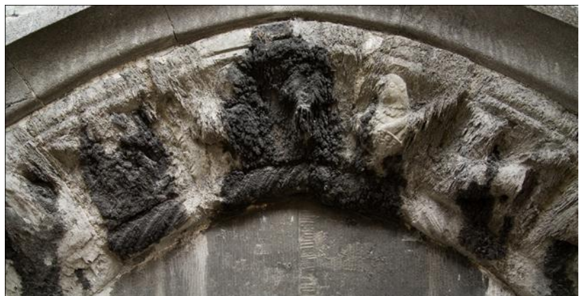
Fig. 24 Détail de la zone avec les sculptures les mieux conservées de la Porte du Capitole.
