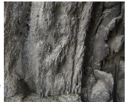
Fig. 43 Exemple d'un délitage prononcé et une croûte de gypse fine ou inexistante
