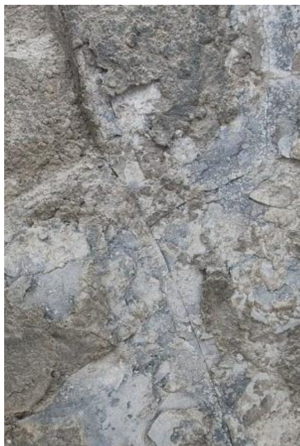
Fig. 14 Microfissures c'est-à-dire des fissures d'ouverture inférieure à 0,1 mm (Porte Mantile, tympan supérieur).
