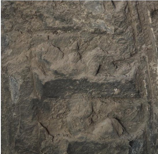
Fig. 21 Croûte noire sous forme de film millimétrique (Porte du Capitole, bandeau cintré).
