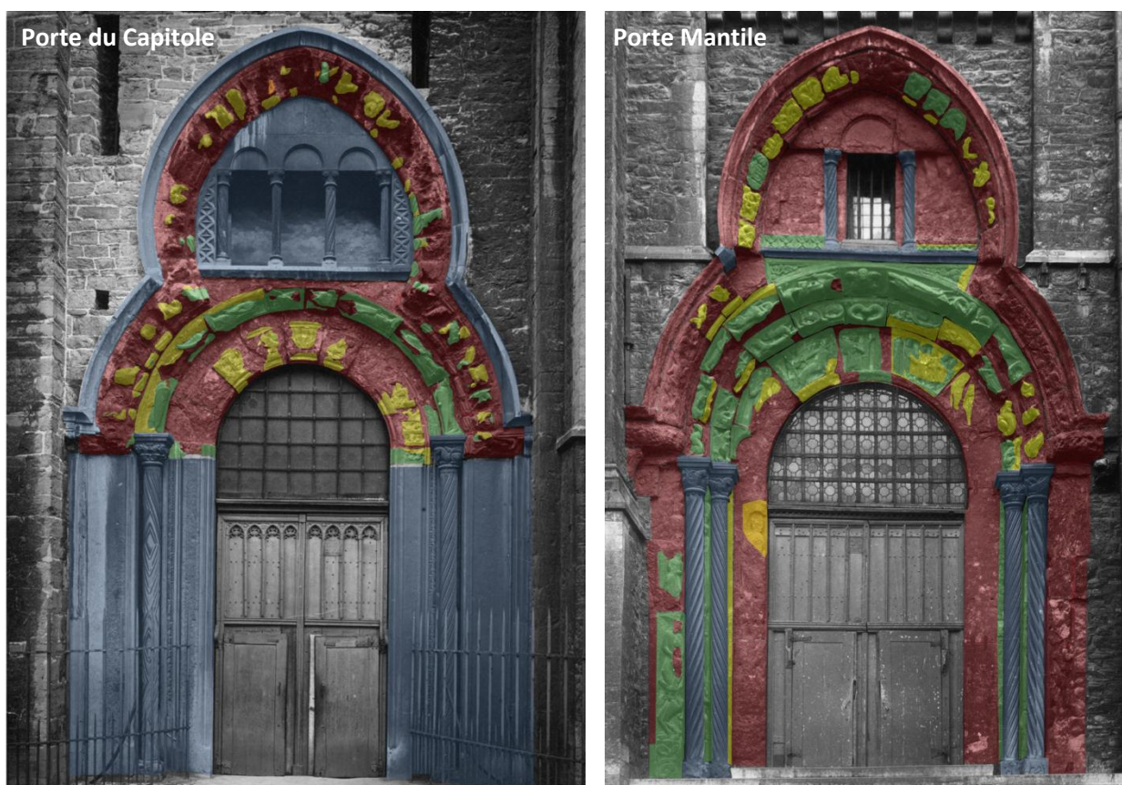
Fig. 31 Cartographies générales montrant la localisation et l'ampleur des zones les plus dégradées : vert= sculptures d'origine bien lisibles ; jaune= des surfaces de pierre où sont encore visibles quelques éléments amorphes de la sculptures d'origine ; rouge= des surfaces disparues de la pierre d'origine .
