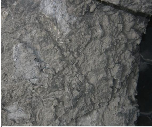
Fig. 18 Délitage superficiel (Porte du Capitole, bandeau cintré).
