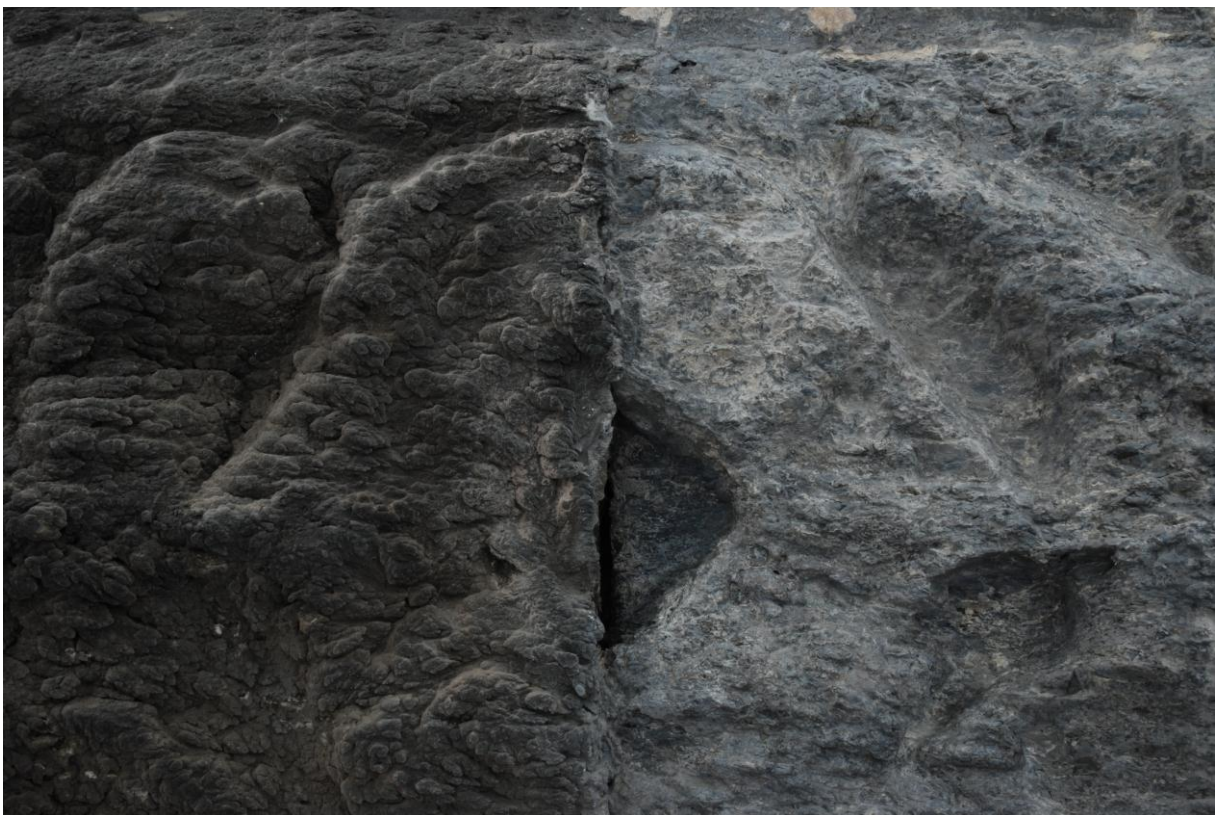
Fig. 59 PM.VT-27(gauche) non traitée et PM.VT-29 ( Zone 1) après traitement
