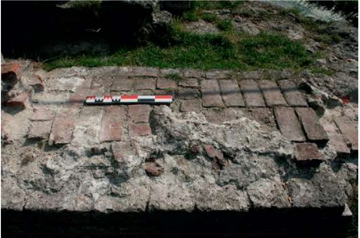
Fig. 3. Porte de Hal, Bruxelles/Saint-Gilles, parement intérieur au deuxième niveau de la tour (P. Sosnowska © CReA-Patrimoine/ULB)
