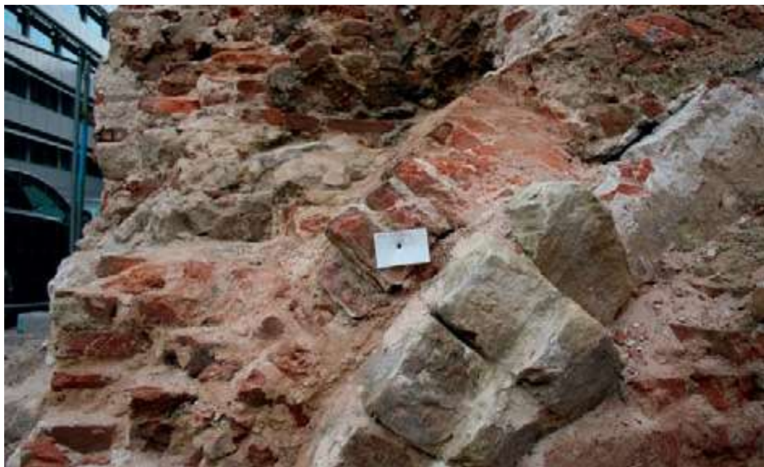
Fig. 6. Rue de l'Escalier, 36, Bruxelles, vue de la cave à l'origine, devant s'étendre sous le n° 38, adjacent. Elle est couverte d'une voûte en berceau posée sur arc doubleau et colonne centrale (xv e siècle) (P. Sosnowska, B. Claes © CReA-Patrimoine/ULB - DMS/SPRB - MRAH).
