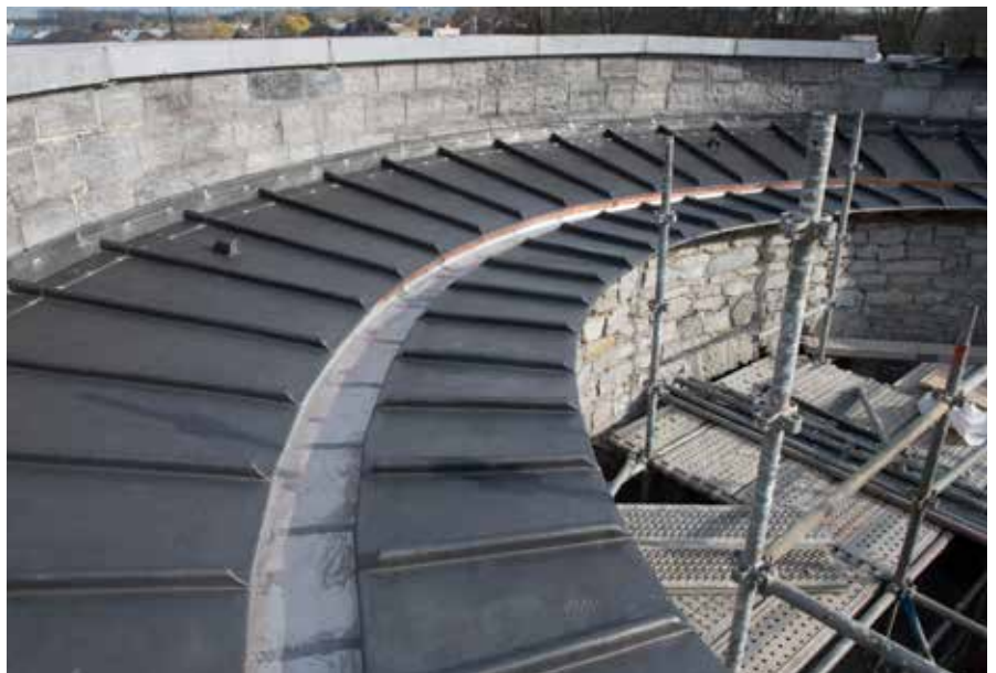
Vue de la partie la plus cintrée, côté aval, avec son chéneau encaissé en Inox AME et un « passe corde » permettant d'assurer la parfaite ventilation du complexe soutenant les tables de plomb.
