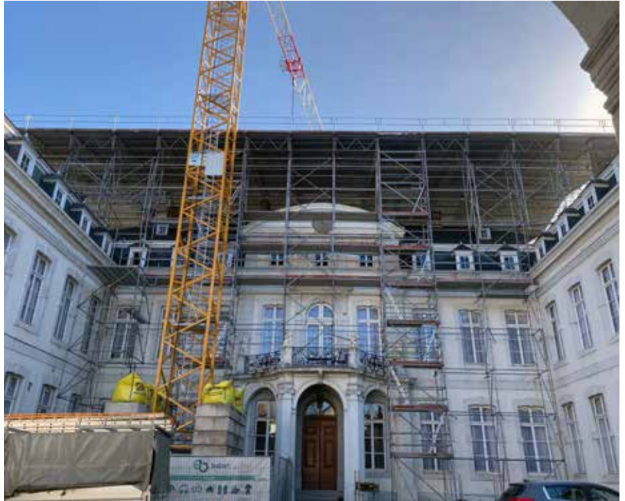
Placement de l'échafaudage et de la toiture provisoire sur l'aile principale en première phase du chantier. © A. Brismé
