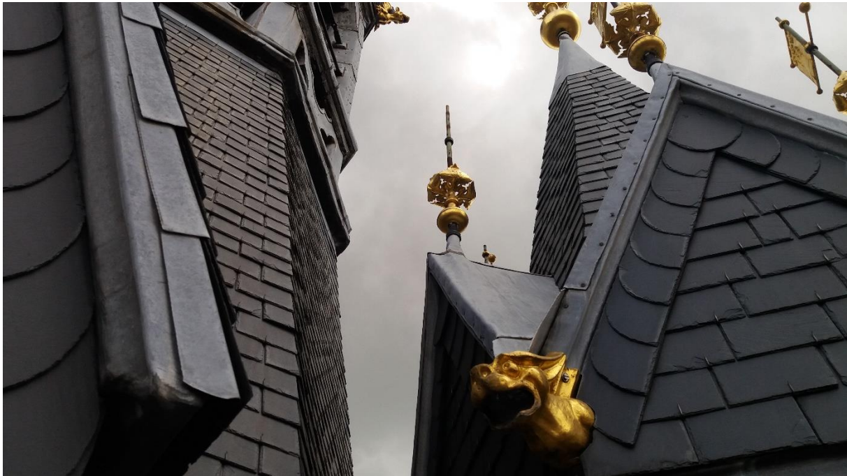
Fig. 12 : Le couronnement de la flèche du beffroi, restaurée à la fin du XX e siècle, joue sur le contraste entre le bleu-gris de l'ardoise, le gris du plomb et les éléments de décor en ferronnerie recouverte de feuille d'or © Auteur
