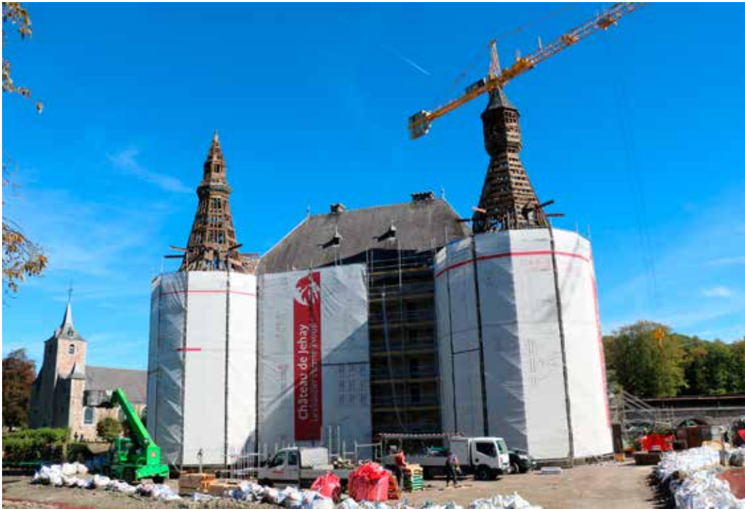
Façade ouest du château de Jehay après dépose des couvertures des deux tours (septembre 2018). © Provincedeliege-Dép-Comm.
