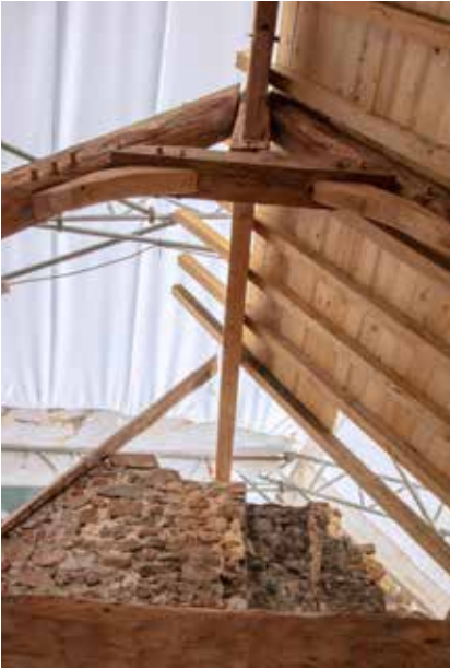
Charpente de l'aile centrale en cours de restauration, château de Jehay (juin 2021).
