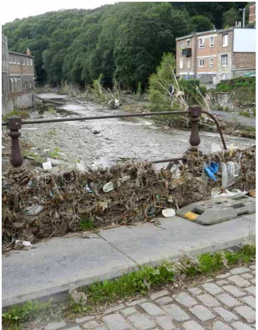
Pont Al Côte sous les débris des inondations, Verviers. © D. R.
