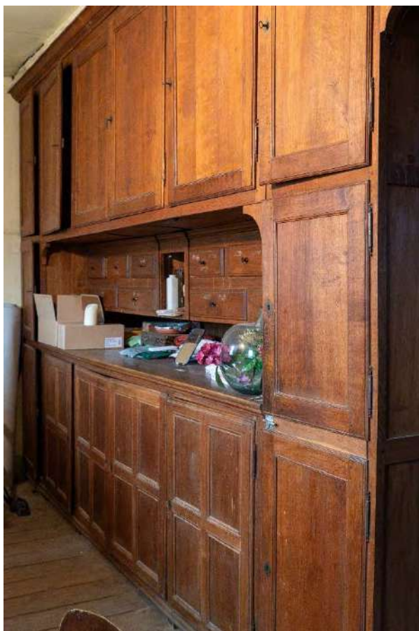
SACRISTIE. MOBILIER DE SACRISTIE D'ORIGINE, TRAVAIL DE MENUISERIE COMPLET AVEC ARMOIRES COUVRANT LE LONG MUR INCLUANT ÉTAGÈRES, TIROIRS DE DIMENSIONS DIVERSES, TABLETTE, NICHES, TIROIRS À CHASUBLES, ACCÈS (PORTE SACRISTIE > ÉGLISE) PHOTO : VINCENT ROCHER, NICOLAS EVRARD (STAGIAIRE) – AWAP - DST
