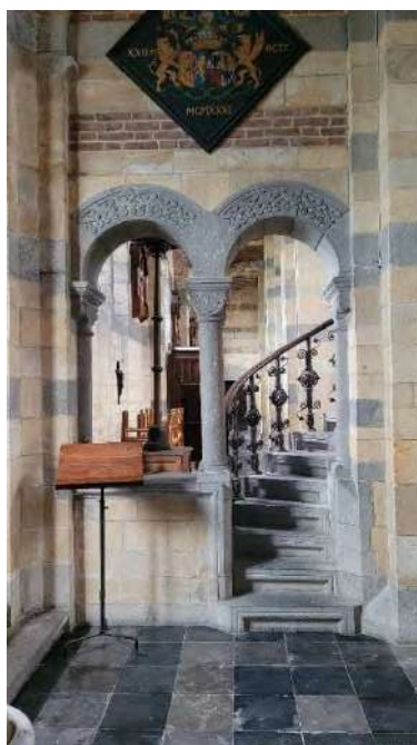
MUR DE CLÔTURE DE LA CHAPELLE SAINT-JOSEPH (BRAS DU FAUX-TRANSEPT DR.) ET ESCALIER DE LA CHAIRE À PRÊCHER. PHOTO : VINCENT ROCHER ET NICOLAS EVRARD (STAGIAIRE) – AWAP - DST
