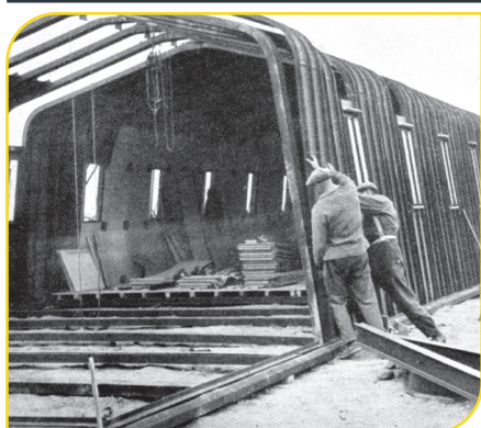
Montage d'un baraquement métallique dans les années 40 (coll. particulière M. Grebot) – Ph. J. Mongreville [1940] © Région Bourgogne- Franche-Comté, Inventaire du patrimoine.
